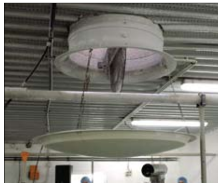
krovni ventilatori CL 600 koji su pokretani kompjuterom, a sastoji se od cijevi, ventilatora, vinč motora te zaštitnih sklopki
